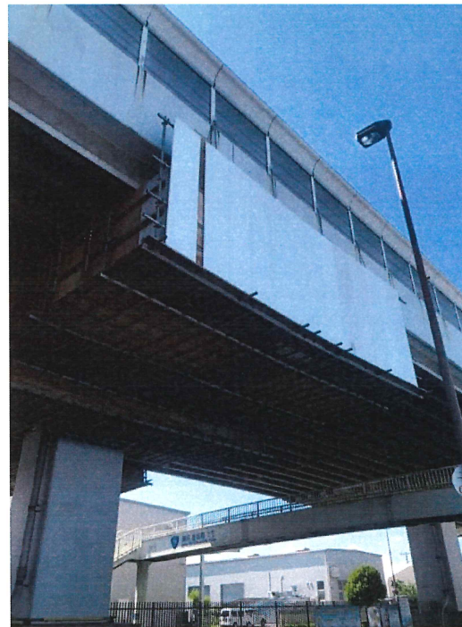
GSシステム 朝顔の支柱と手摺は 単管とクランプを使用
